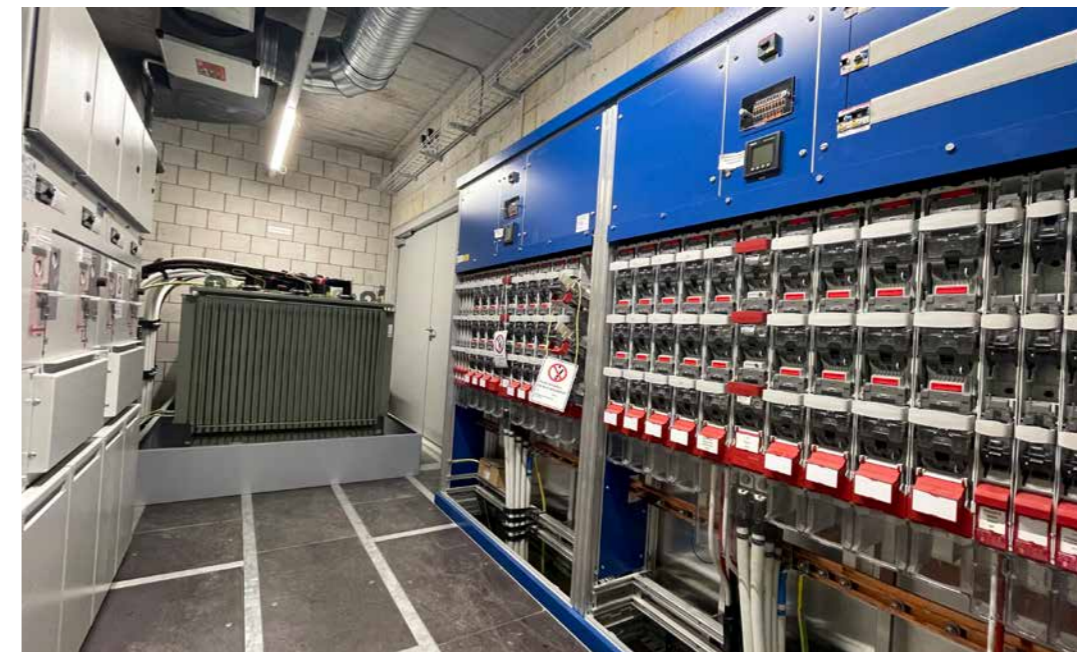
Die neue Trafostation Seepark befindet sich in der Tiefgarage der Überbauung Seepark.
