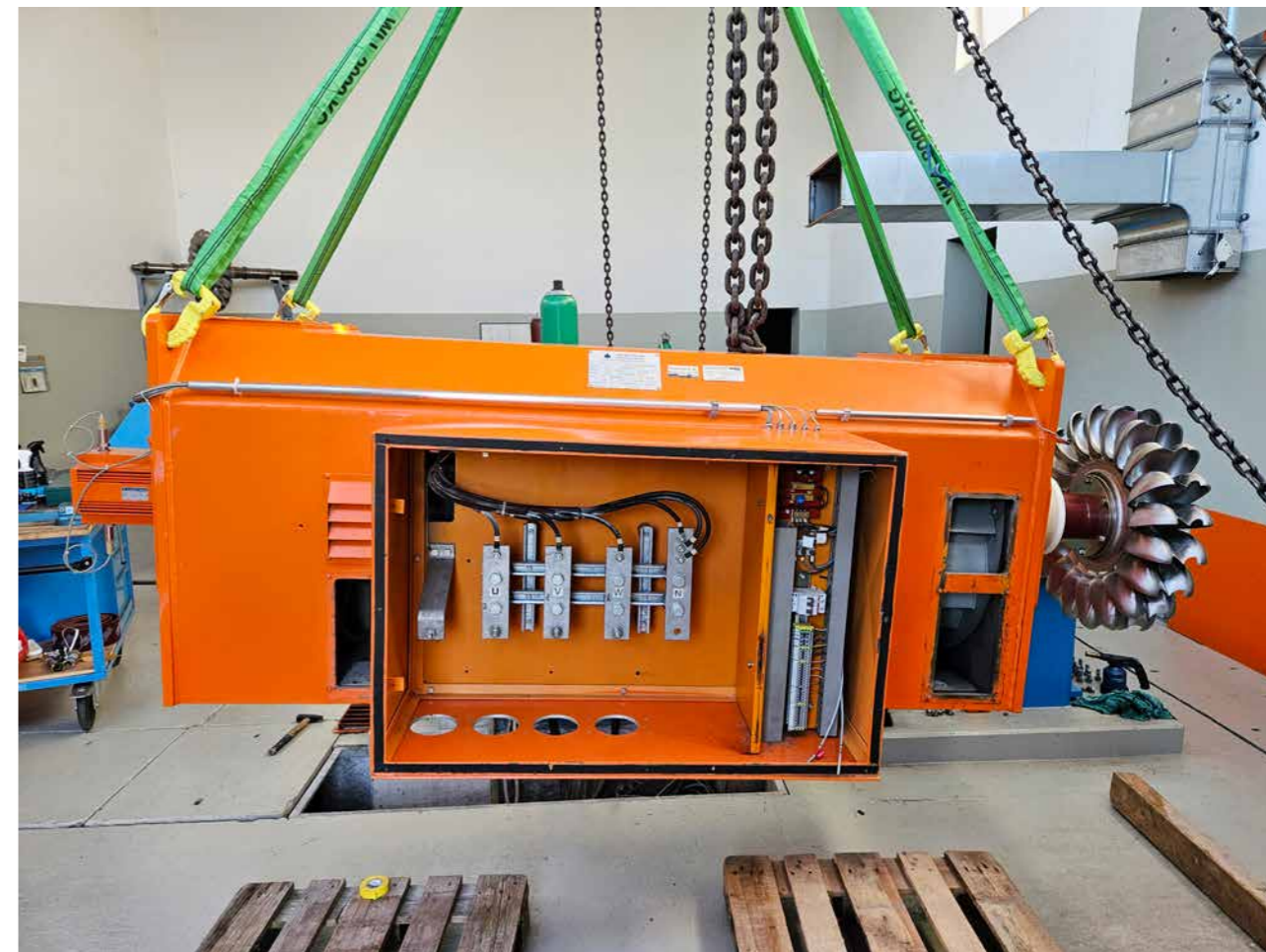
Der Generator musste für die Revision demontiert werden.
