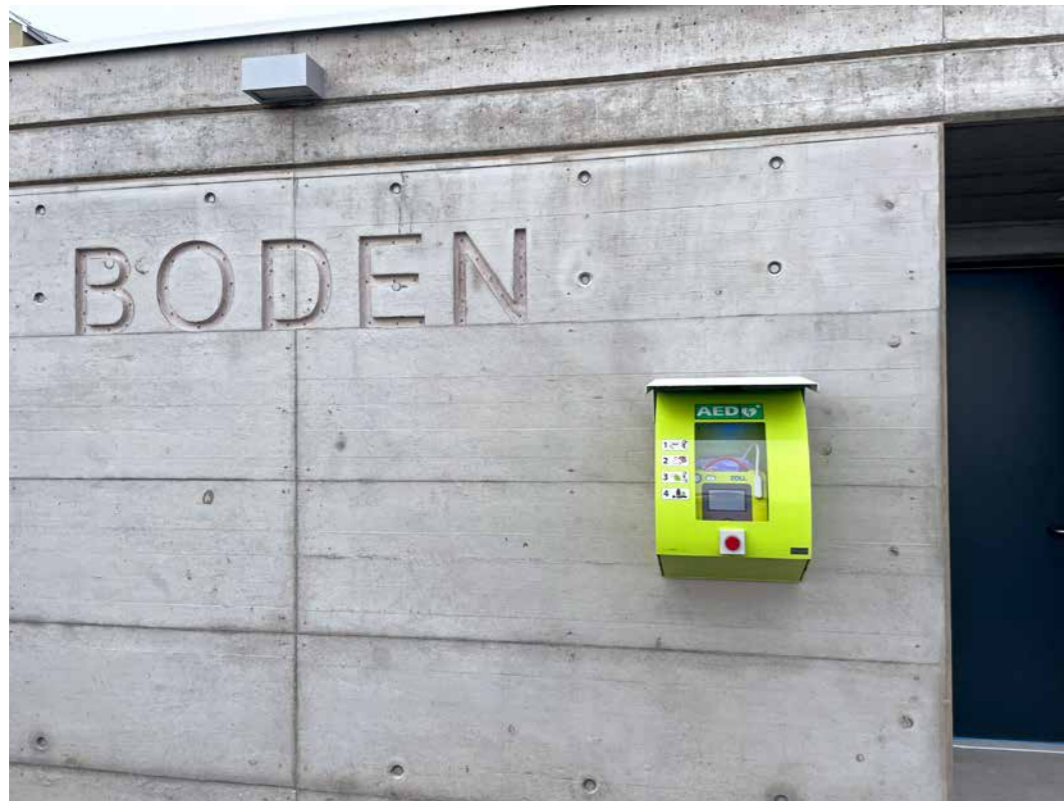
Standort Defibrillator bei der WC-Anlage Boden.
