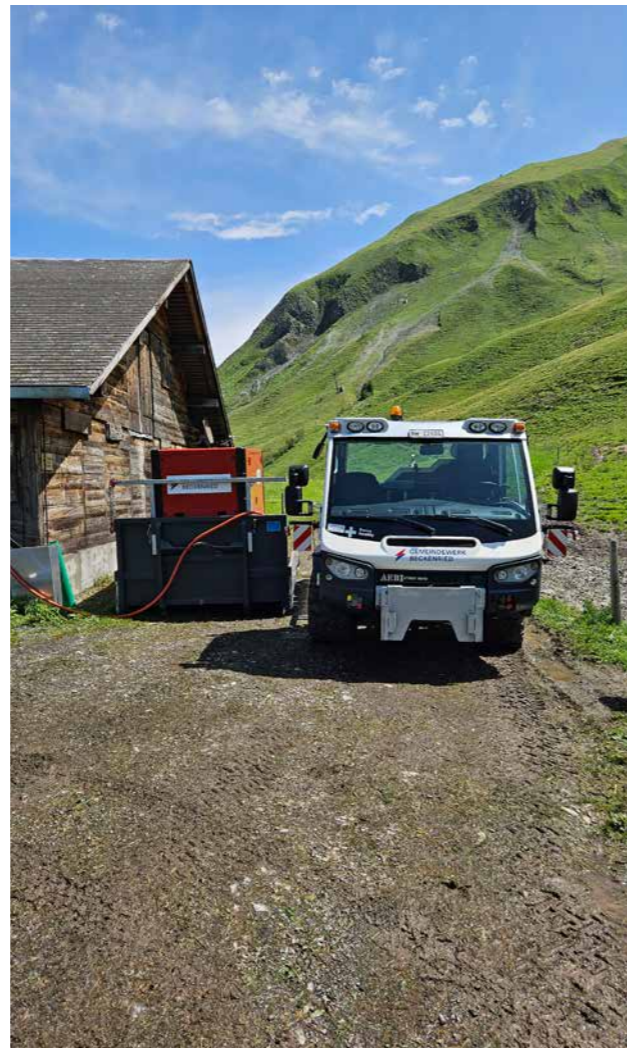
Notstromversorgung bei der Alp Unter Büel mit dem Dieselnotstromaggregat.
