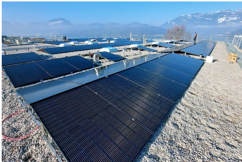
Photovoltaikanlage auf dem Dach des DLZ
