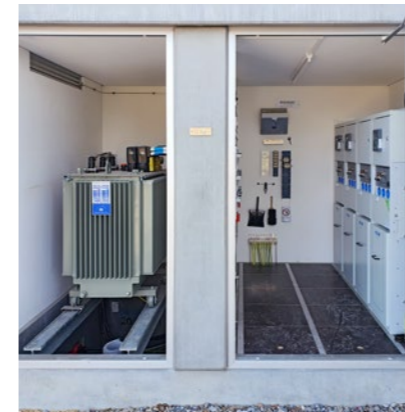
Trafostation Napf: Transformator und MS-Schaltanlage
