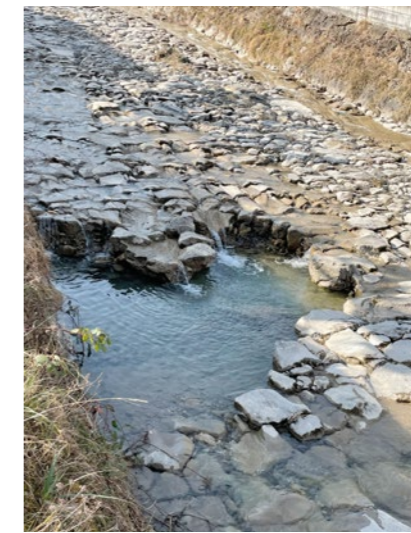
Beschädigte Bachsohle beim Lielibach
