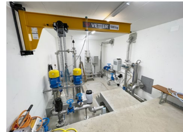
Pumpwerk Tannibüel: Innen- und Aussenansicht
