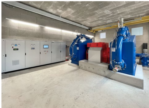
Maschinengruppe KW Napf und Zentralegebäude KW Napf mit dem Ausgleichsbecken
